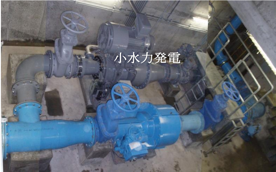
図 2-13 「小水力発電施設」
